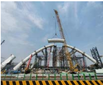
项目安装点位测控
